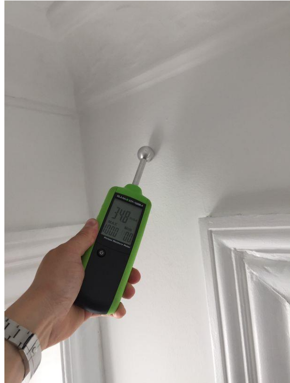
Fugtmåling ved ydervæg i karnap i dagligstue
