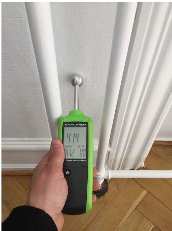
Fugtniveau i ydervæg i soveværelse
