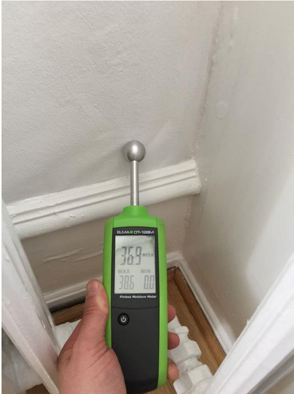
Fugtmåling ved ydervæg i karnap i dagligstue
