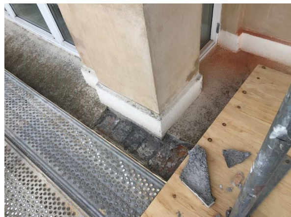
Løs og revnet pudslag på gesimsbånd ved spisestue
