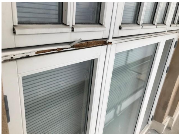
Råd i vandret post i vindue i front af karnap v. spisestue
