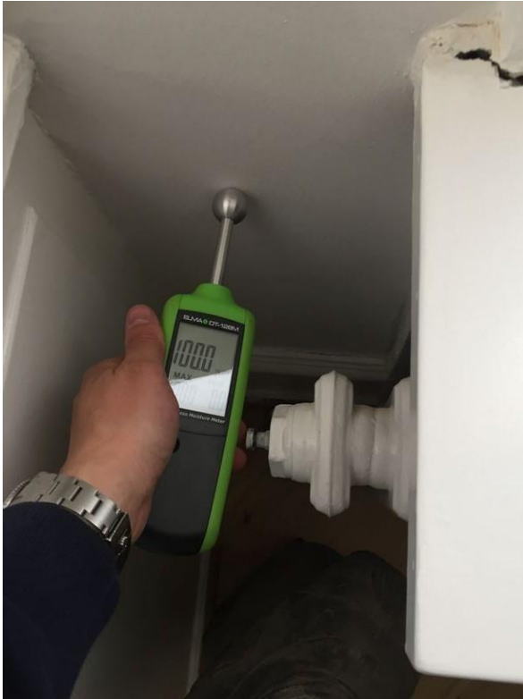
Fugtmåling ved ydervæg i karnap i spisestue
