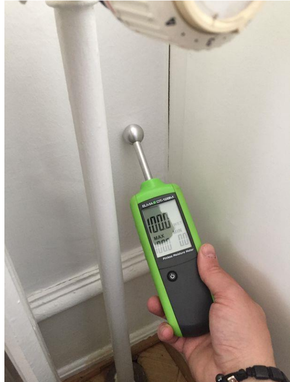
Fugtmåling ved ydervæg i karnap i spisestue
